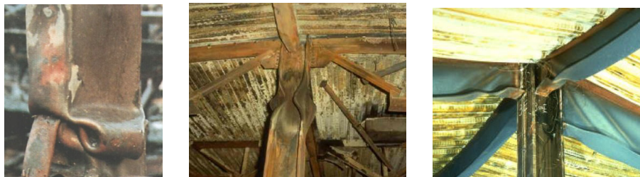
Slika 23. Plastično tečenje i deformacije čeličnih stubova i greda
