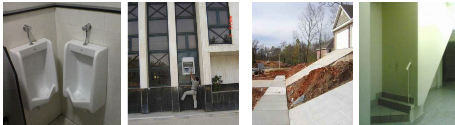
Slika 5. Realizovane greške – posledica nedovoljne koordinacije u toku izgradnje 18
