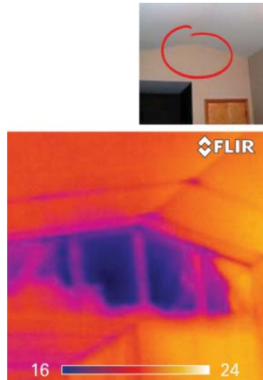
Недостатак изолације, посматрано изнутра хладнији део зида, знатан губитак енергије. Missing insulation seen from inside, significantly colder part of the wall severe energy loss.
