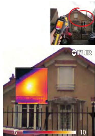
Недостатак изолације посматрано споља значано топлији део зида, знатан губитак енергије. Missing insulation seen from outside, significantly warmer part of the wall severe energy loss.
