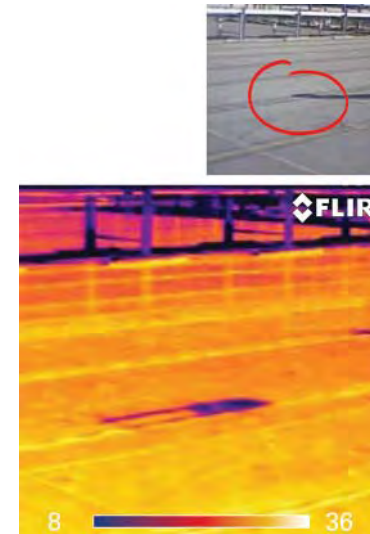
Цурење равног крова. Јасно уочљива зона влажне изолације омогућава ефикасну и брзу поправку. Leakage of flat roof construction. Clearly visible zone of wet insulation enables efficient and fast repair.
