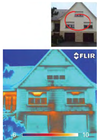
Продување кроз фасадну објекта услед лоше изведене заптивености. Air leakage through façade due to the low quality of wall construction.
