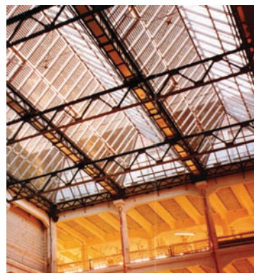
Сл. 12. Шед кров са полутранспарентним ФЕ модулима изнад атријума, Zentrum für Kunst und Medientechnologie, Karlsruhe, Немачка, ревитализован индустријски објекат Fig. 12. Shed roof with semi-transparent PV modules above the atrium, Zentrum für Kunst und Medientechnologie, Karlsruhe, Germany
