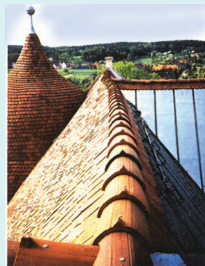
б) Колектори на крову дворца Schloss Grossmehlen b) Roof collectors on the palace Schloss Grossmehlen
