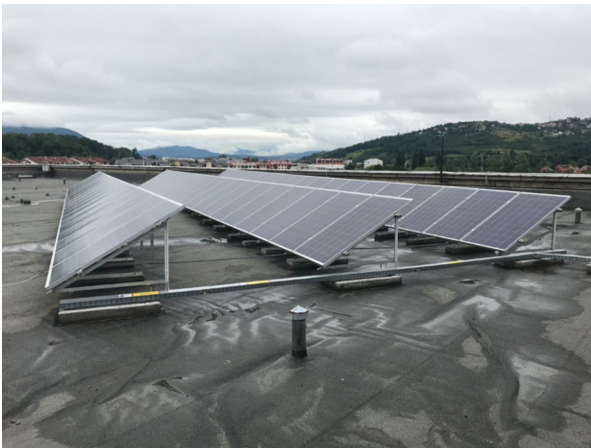
Слика 15. Пример инсталације фотонапонске електране на равном крову (Зграда Електротехничког факултета у Источном Сарајеву – БиХ).
