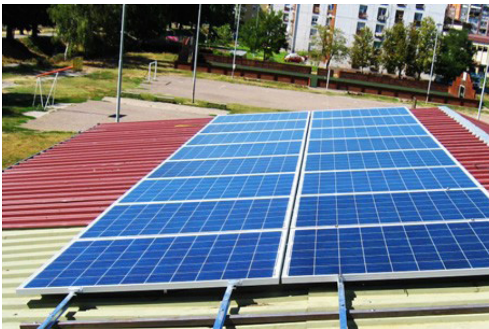
Слика 16. Пример инсталације фотонапонске електране на косом крову (Зграда Техничке школе у Пироту)
