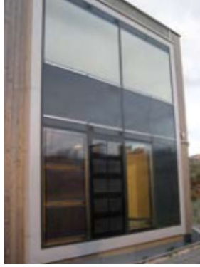
Slika 4. Transparentan solarni toplotni kolektor integrisan u fasadu
