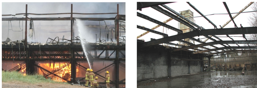
Slika 4. Plastične deformacije sekundarnih i tercijernih čeličnih nosača 5
