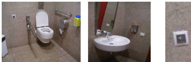
Slika 7. Oprema sanitarnih prostorija
