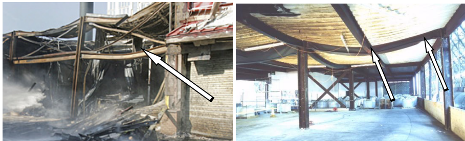
Slika 2. Deformacije čeličnih nosača tokom i posle požara 3
