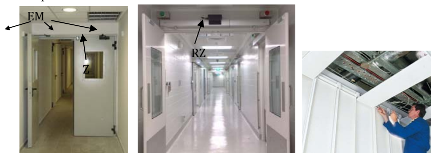
Slika 14. Levo F i VD vrata srednja slika; na prvoj slici je jedno krilo u položaju "normalno otvoreno" a drugo krilo je "otpušteno" /strelicama se ukazuje na delove elektromagnetnog "držača" vrata koji kad ostane bez napona dozvoljava da mehanizam Z zatvori krilo; radi
