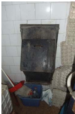
Slika 5. Prijemnik za elevator u jednom od objekata u bloku 62
