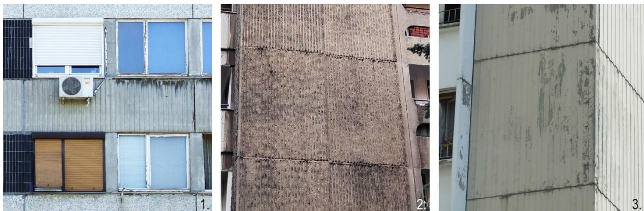
Слика 24. Полупрефабриковане фасаде: 1. парпети зграде 21/В-8 (ППП ТИП 1); 2. једноетажни елементи (ППЈ ТИП 1) свих зграда у блоку 29 и 3. једноетажни елементи (ППЈ ТИП 1) зграда од 30/1 до 30/5 у блоку 30 (Фотографије аутора)
