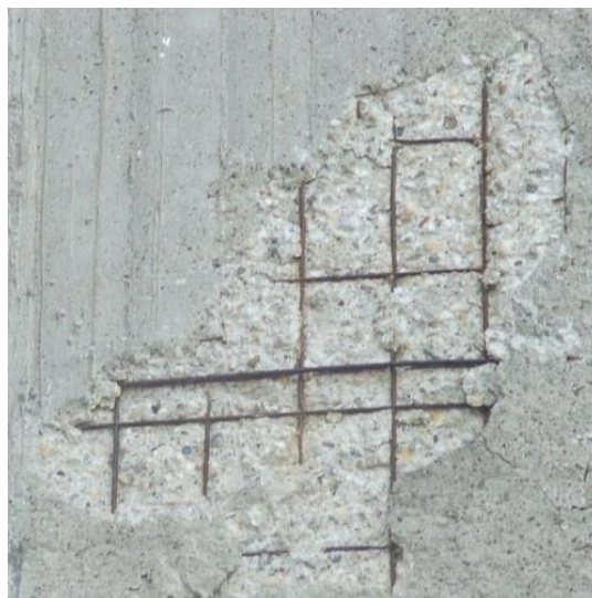
Слика 54. Пример присуства корозије код арматуре бетонског зида и проблем недовољне пројектоване дебљине заштитног слоја арматуре у бетону који је делом и отпао (Фотографија аутора)
