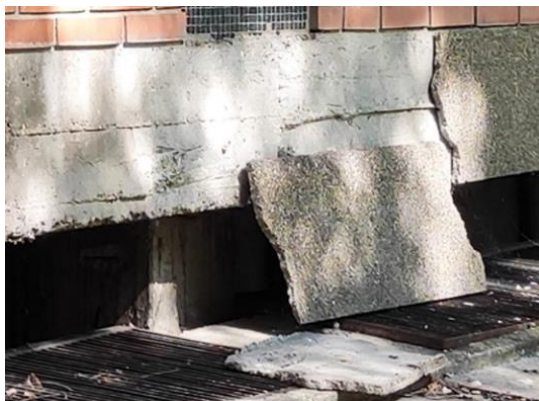
Слика 53. Приказ отпалих делова слоја кулије бетона са површине ивичног армиранобетонског елемента у зони сокле зграде – пример накнадног постављања слоја кулије бетона (Фотографија аутора)
