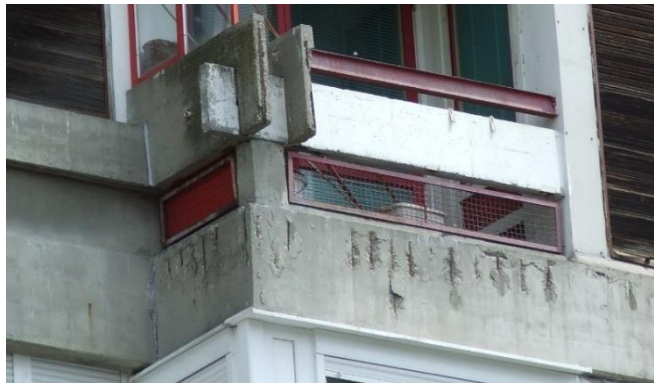
Слика 50. Приказ разлике у квалитету бетона префабрикованих елемената - парапетни елемент без оштећења (лева зона фотографије) и линијски елемент са оштећењима (централна зона фотографије) (Фотографија аутора)
