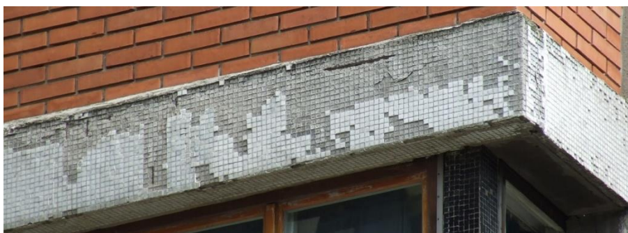
Слика 51. Одсуство стаклених мозаик плочица (плочице уграђене једновремено са осталим слојевима у процесу производње префабрикованог конзолног елемента) услед њиховог отпадања у зони ивичног ребра касетиране конзолне таванице (Фотографија аутора)
