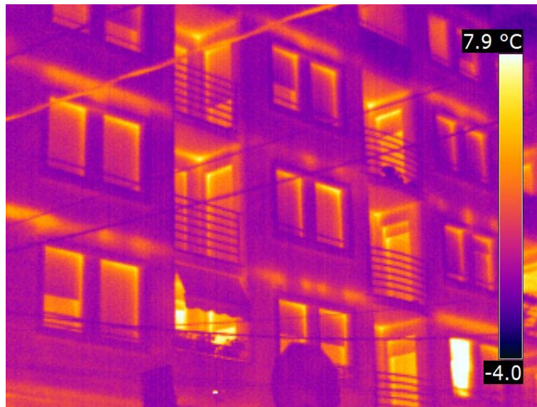
Слика V-32 Приказ дела фасаде зграде са приметном разликом у квалитету извођења где се јасно уочавају зоне са удвојеним серкљажима и изведеним према пројекту (изнад прозора у средишњем делу ) у односу на лоше изведене готово континуалне серклаже (изнад прозора на левом делу приказаног сегмента)
